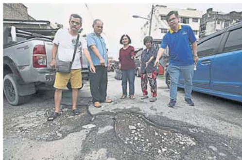
郑东和（右）巡视沙登新村 SK11/4 路的路洞情况，并呼吁梳邦再也市议会尽快重铺道路，解决困扰居民多年的问题。
